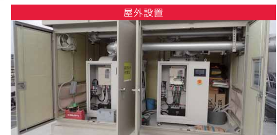
屋外設置 弊社のキュービクル型BOXを利用した屋外設置の実例。ターボブロワと一緒にご提案することができます。
